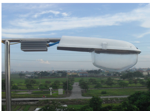
Hình 8: đèn đường LED công suất 100 W sử dụng chất lỏng chứa thành phần MWCNTs
