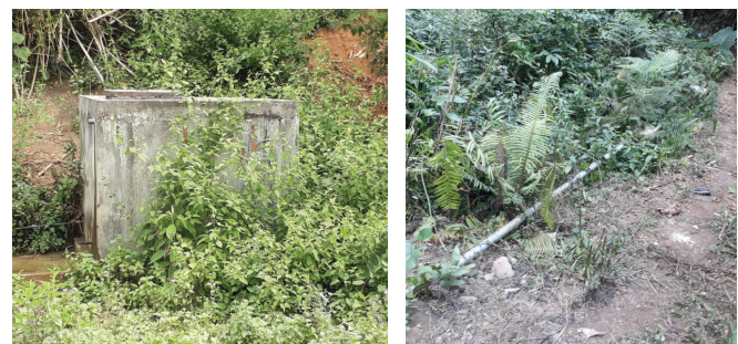
Hình 6. Hình ảnh đầu mối và đường ống cấp nước sinh hoạt.
