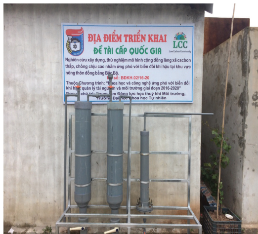
Hình 3. Hệ thống xử lý khí sinh học.
