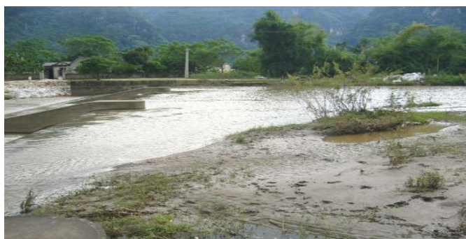
Hình 1. Bồi lấp đầu mối đập dâng công trình.
